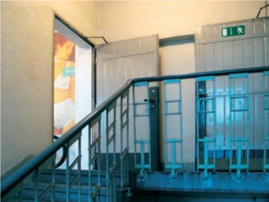
Das Treppenhaus im Anbau von 1914 ist noch weitgehend bauzeitlich erhalten. Die Treppengeländer sind in zurückhaltendem Jugendstildesign ausgeführt.
