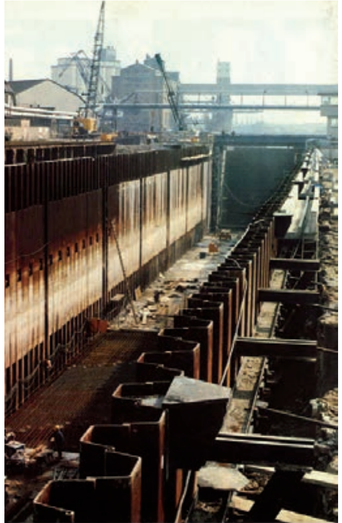
Unser Bild stammt aus dem Ende der Bauphase 1984 und erschien im Artikel „Moderne Spundwandtechnik für Kammerschleuse Mannheim“ in der Zeitschrift „Werk und Wir“ Nr. 5/84, Hoesch AG (Foto: Manfred Kampmann). Bei der Schleuse handelte es sich um die erste, deren Kammerwände mit einer zusätzlichen Hoesch-Stoßpanzerung ausgerüstet wurden.
